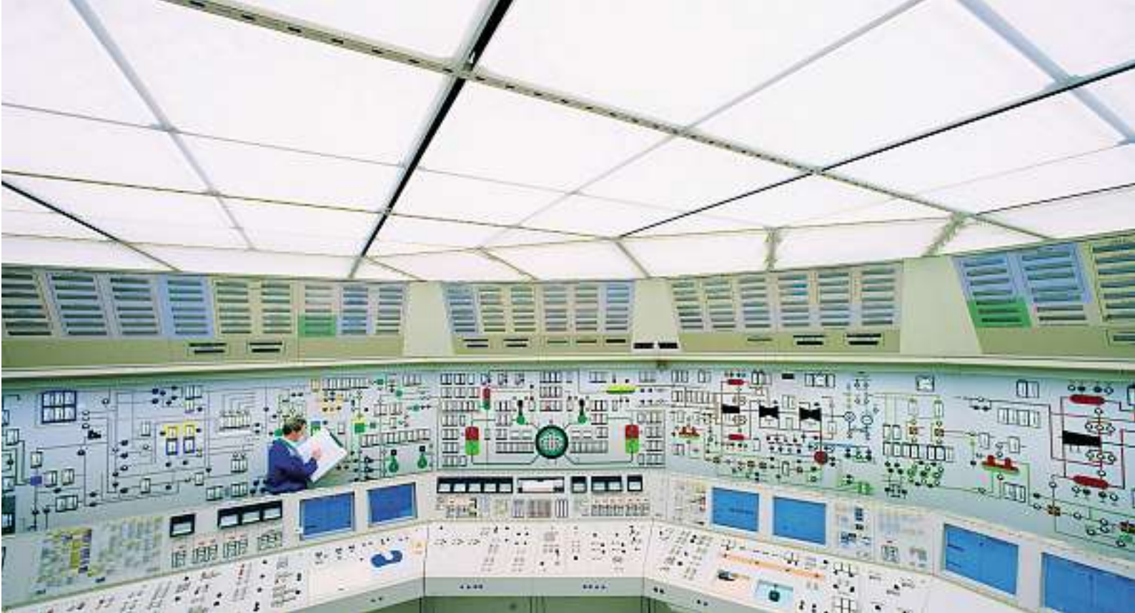
Bild: Blick in den Kommandoraum (KKB)
