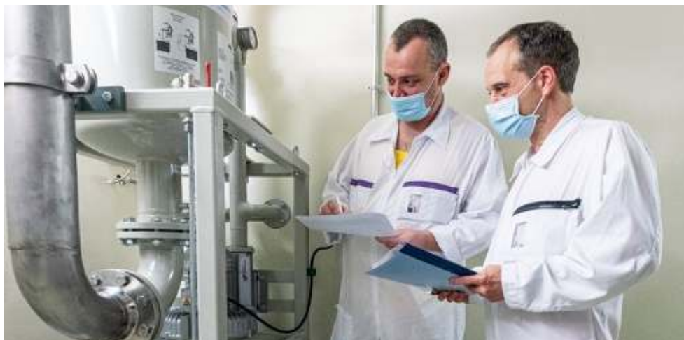
Dans l'enceinte de confinement: mise en service d'un ventilateur à vapeur d'huile pour la régulation de la dépression dans le système d'huile de lubrification d'une pompe de refroidissement principale. Image: centrale nucléaire de Gösgen
